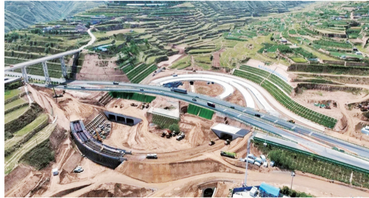
G2201兰州南绕城高速黄峪镇出入口新建项目下穿南绕城高速右幅框架桥主体工程日前施工完成,路面工程开始施工。
