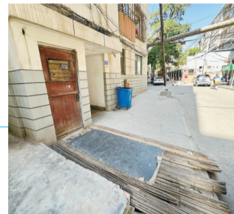
居民楼前未回填的坑。
