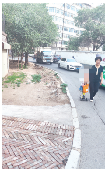
地面未进行硬化处理。
