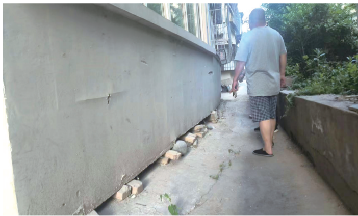
居民楼地基塌陷相当明显。
