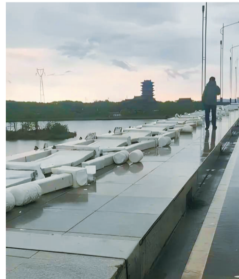
大桥围栏被大风吹倒。视频截图
