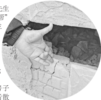
下沉散水造成墙体开裂。
